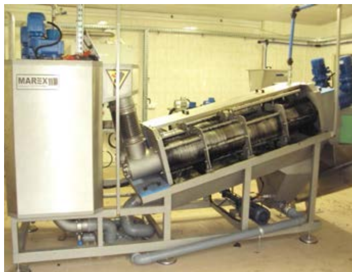
Nowoczesna prasa do oczyszczalni ścieków w Liskowie, o wartości 541 200 złotych, została zakupiona dzięki funduszom pozyskanym z PROW 2014–2020.
