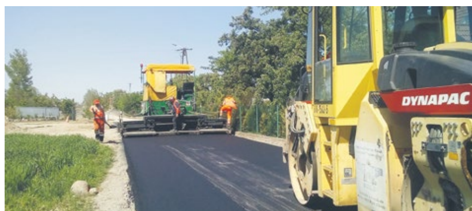
Dzięki środkom z PROW 2014-2020 w miejscowości Brdów w gminie Babiak powstała nowa nawierzchnia drogi gminnej.
